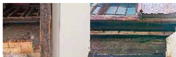
図-17 東側外部柱小舞跡
