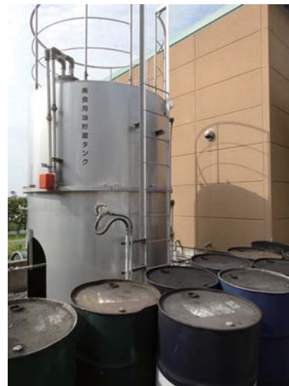
図2 廃食用油貯蔵タンク (搬入されてきた廃食用油は建屋外のタンクに一時的に貯留される。)
