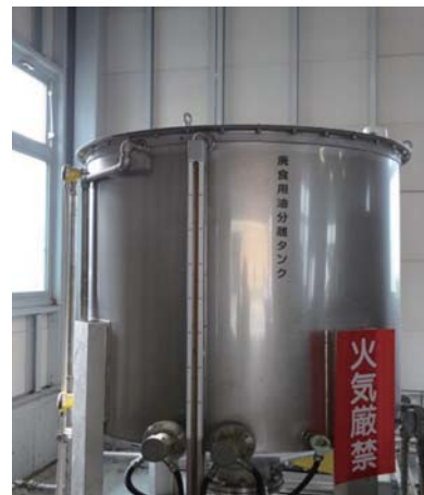
図3 廃食用油分離タンク
