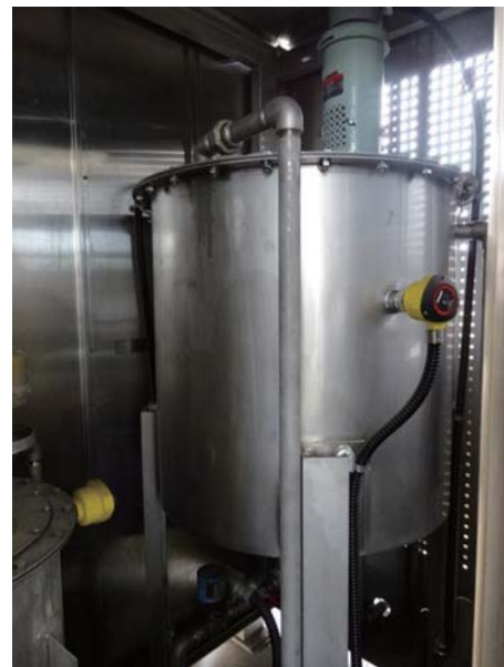
図7 軽油代替燃料化装置内にある反応容器 (左下がメタノール+KOH混合タンク)
