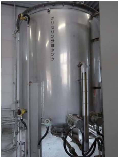
図9 グリセリン分離タンク
