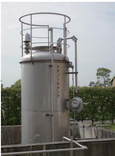
図1 メタノール貯留タンク
